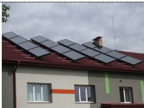
Slika 2: Ugrađeni solarni kolektori
