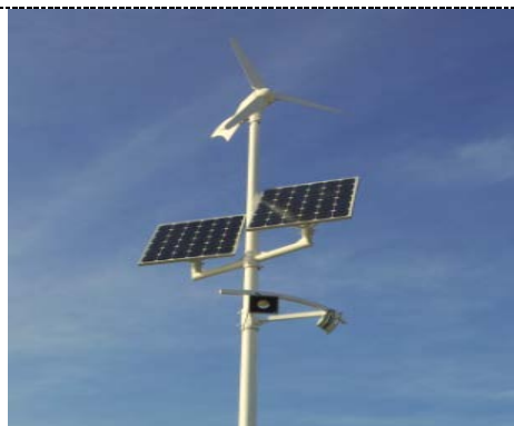
Slika 3: Izgrađena javna rasvjeta pogonjena na solar i vjetar
